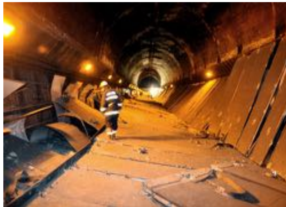
中央道笹子トンネル中央パネル落下事故(H24年12月) 「笹子トンネル天井板崩落事故写真(提供:大月消防本部)」
