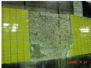
首都高速八重洲線トンネルタイル剥離 (首都高速道路公団Web)
